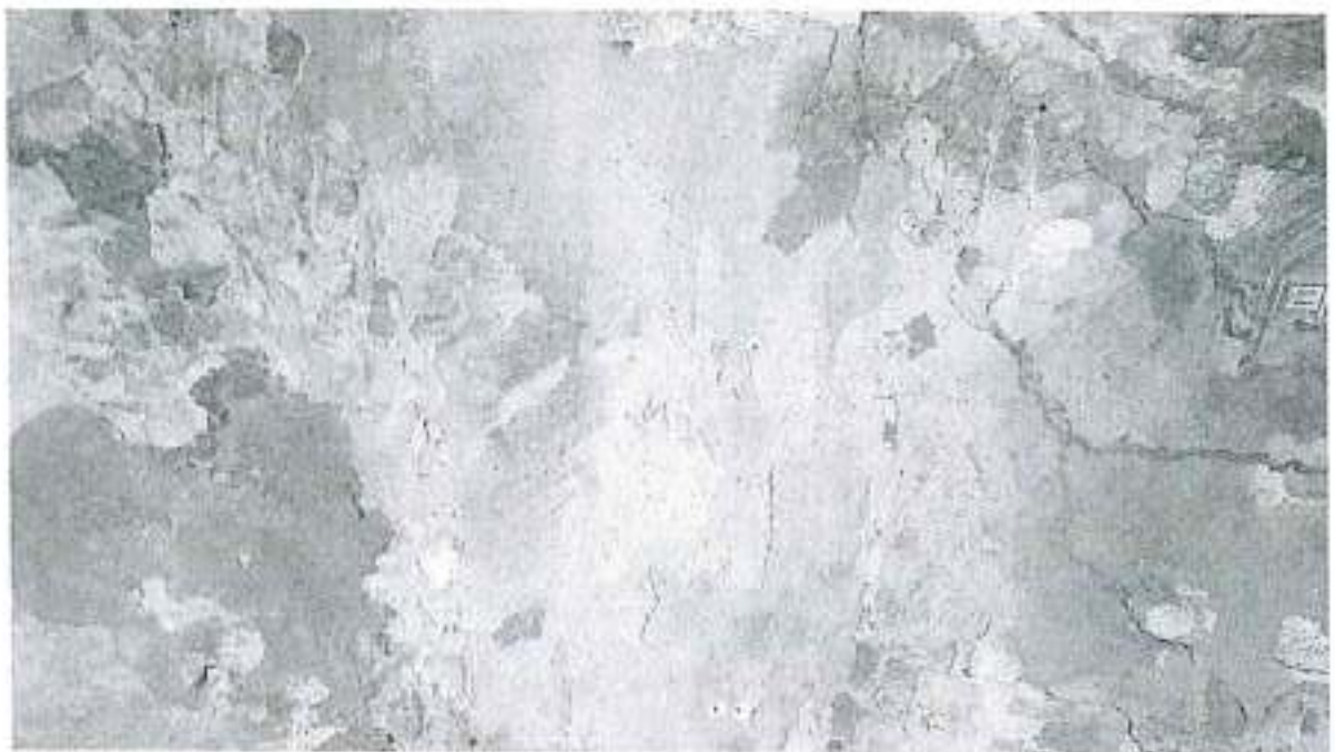
14. Сохранившаяся живопись. Северный придел св. архидиакона Стефана. Фрагмент свода. Поздние штукатурные вставки. Трещины
