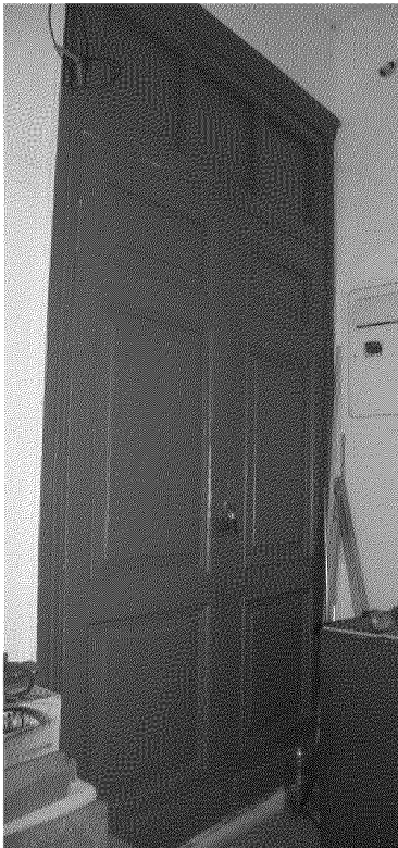
Видовая точка № 26. Подъезд №4. Переустановленная внутриквартирная дверь (3-й этаж)
