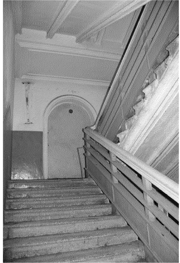
Видовая точка № 21 Парадная лестница с деревянным ограждением и элементы штукатурного декора (1 этаж)
