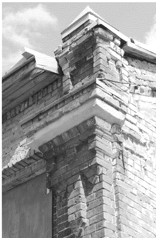
Видовая точка № 20. Набережная р. Томи, 25. Фрагмент лопатки и парапетный столбик (Яблонская М.А., 04.05.2022)
