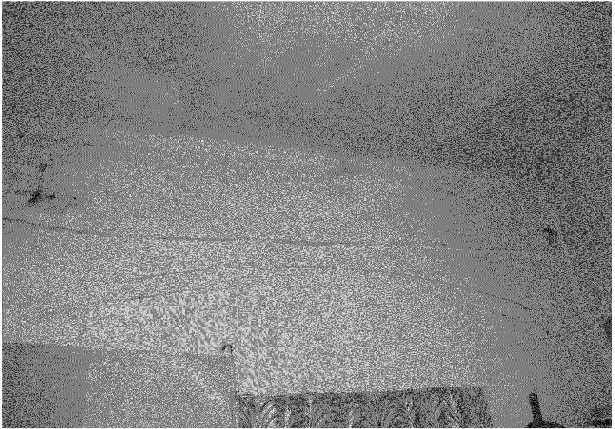
Видовая точка № 34 А. Иванова ул., 2/1. Заложенный крупный арочный проем в квартире 2-го этажа (Вакер И.С., 11.12. 2012)
