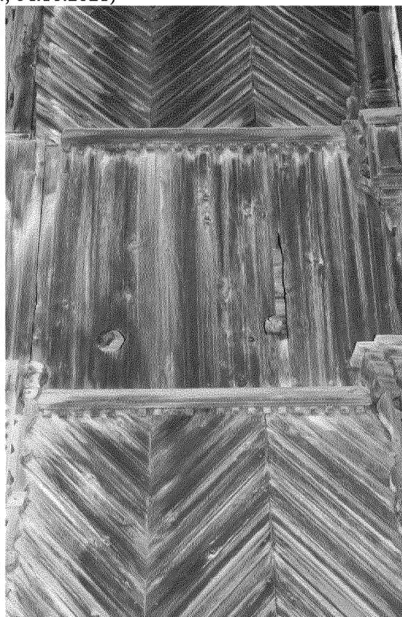
Видовая точка № 8. Обшивка фасада основного объема, вентиляционные продукты (Яблонская М.А., 04.10.2021)
