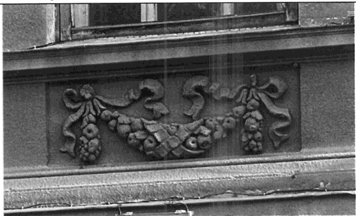
Лепной декор, расположенный на боковых ризалитах по оси окон над окнами 1 этажа.
