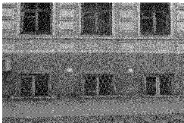
фрагмент главного юго-западного фасада объекта культурного наследия (гладкие наличники в оформлении прямоугольных оконных проемов цокольного этажа, кордон раскрепованного высокого цоколя)
