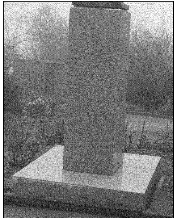
основание и пьедестал памятника М.Б. Грекова, входящего в состав объекта культурного наследия
