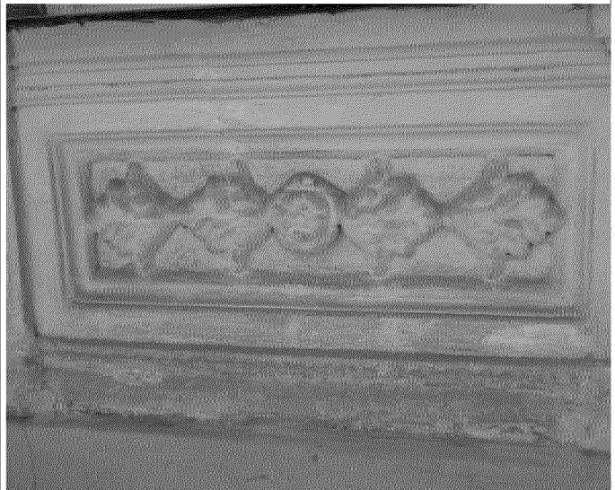
подоконная ниша на главном северо-западном фасаде объекта культурного наследия (фото 07.2021 г.);
