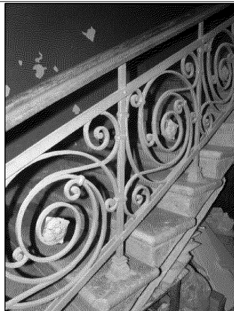
ограждение междуэтажной лестницы в южной части объекта культурного наследия
