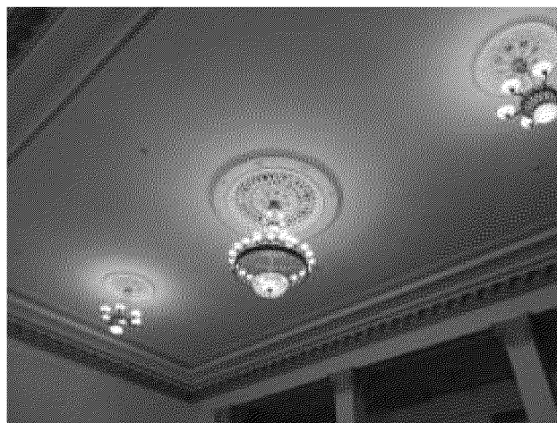
потолочные розетки с вентрешетками в помещении № 8 четвертого этажа
