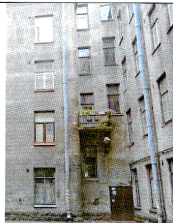
Балкон (правая часть С-3 дворового фасада)
