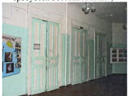
Двери между пом. 2.2 и 2.3. фото 2008 г. (утрачены, необходимо восстановление)
