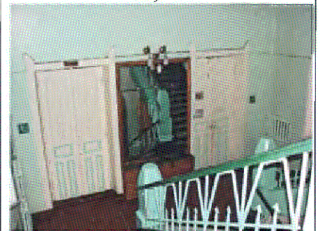
Двери между помещением главной лестницы и пом. 2.1. Фото 2008 г. со стороны лестницы (утрачены, требуется восстановление)
