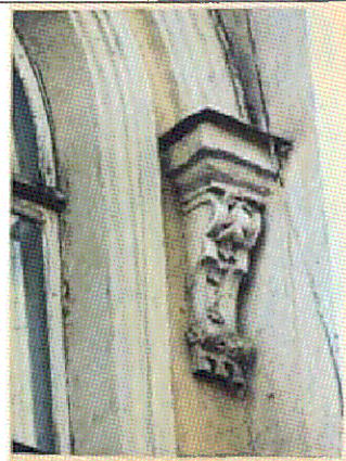
Консоль сандрика проемов Ю-3 фасада, 2-ой ярус (на ризалитах, и по краям в центральной части), фото 2006г.
