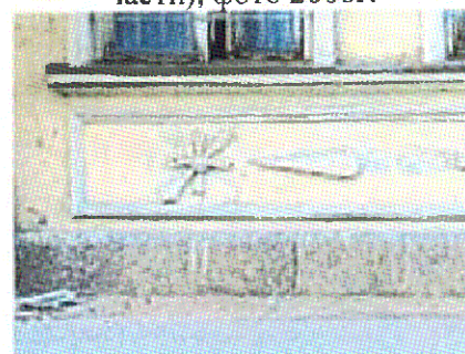
Подоконные пояс и филенка (Ю-3 фасад, центральная часть, 1-ый ярус), фото 2006 г.
