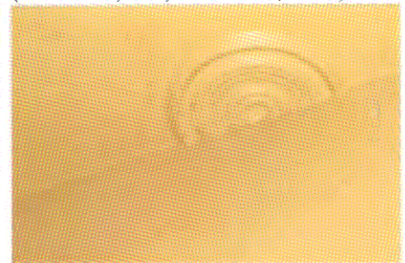
Потолочная розетка (пом. 1.5)
