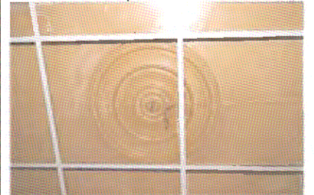
Потолочная розетка (пом. 1.13)
