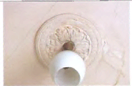
Потолочная розетка (пом. 1.1, 2.2, 2.3, 2.10, 2.13)
