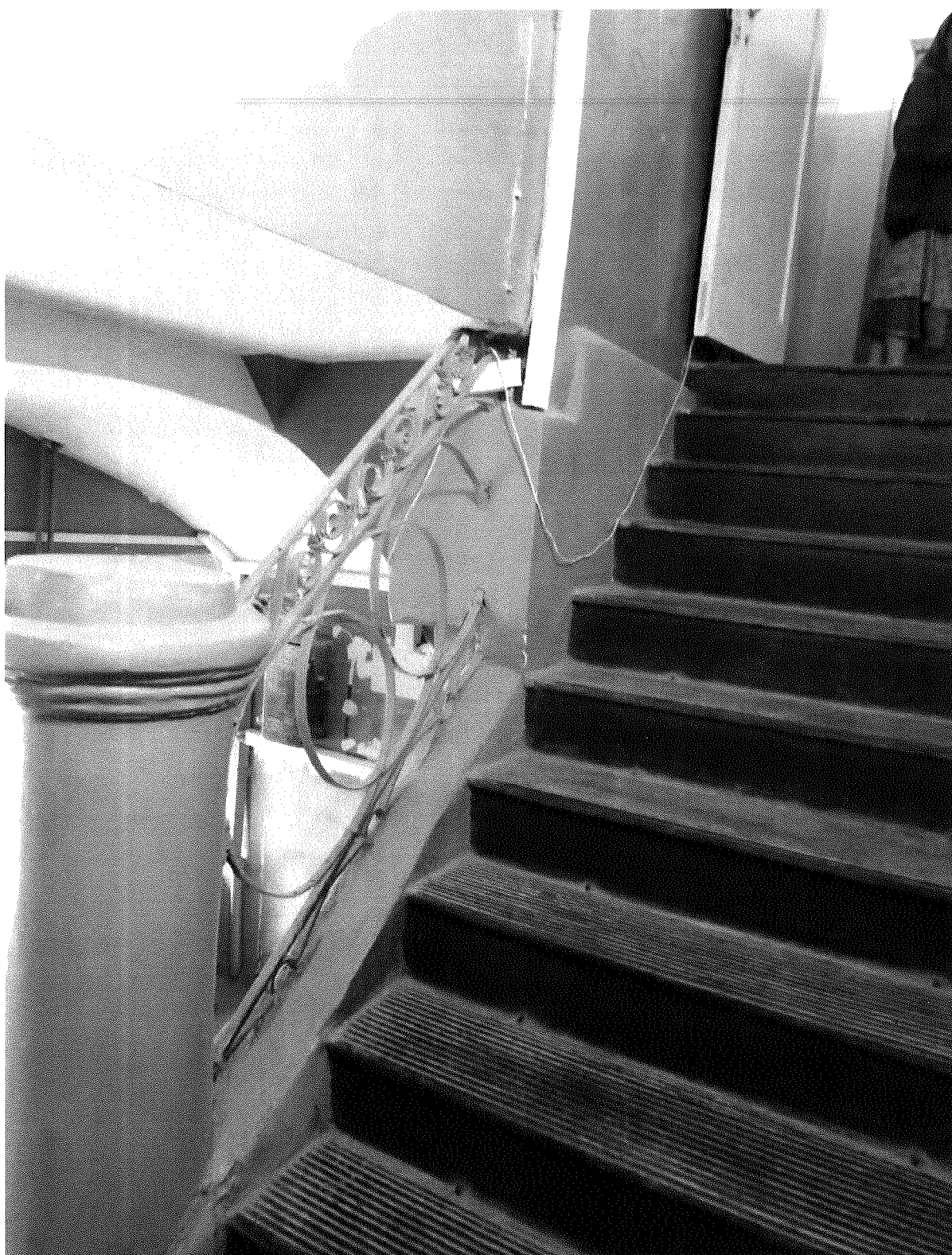
Г-образная лестница с ограждениями в виде кирпичных тумб и коваными металлическими заполнениями между ними
