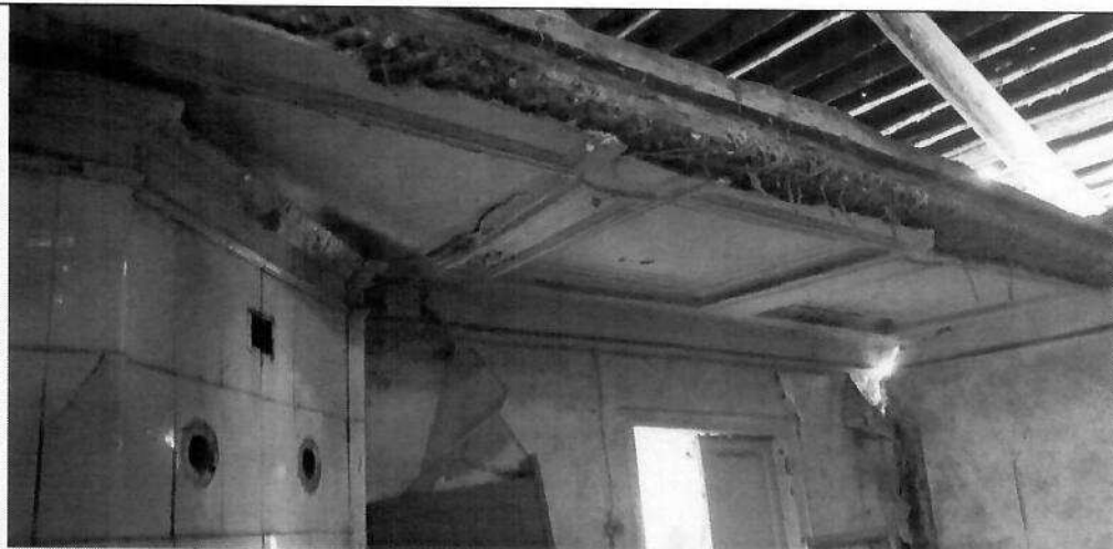
Рис.19. Фрагмент раскрытого перекрытия по месту обрушения конструкций в северо-западном помещении. Фото 2020 г.
