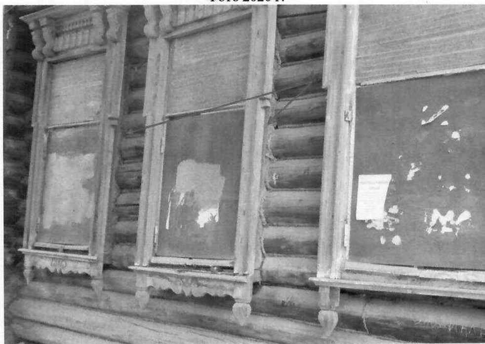
Рис.18. Колоды оконных проемов северного фасада. Фото 2020 г.
