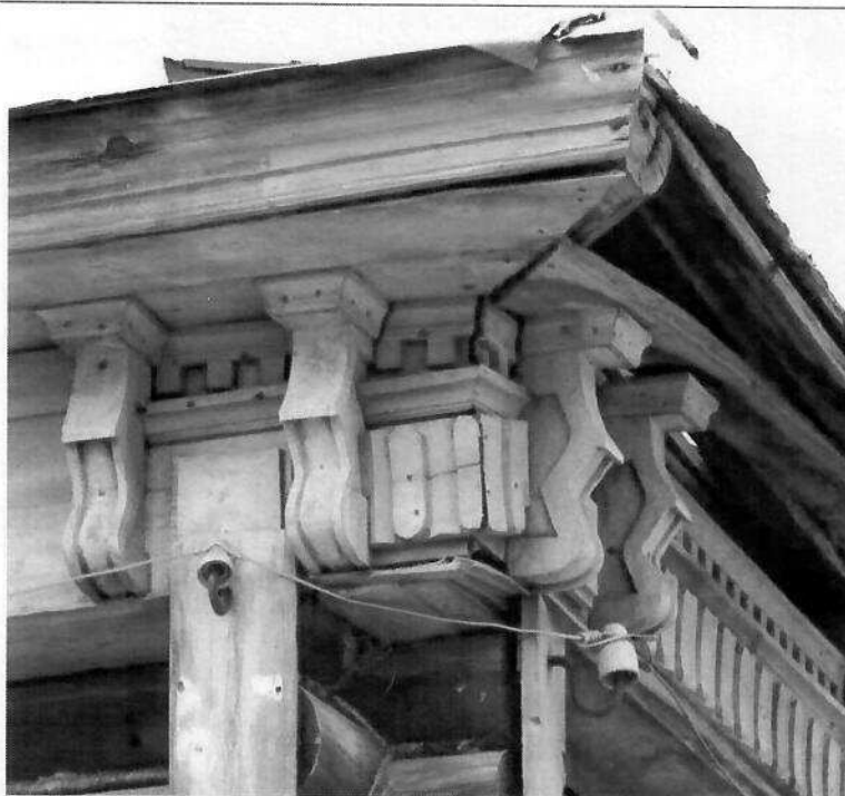
Рис.28. Фрагмент венчающего карниза, северо-восточный угол: спаренные кронштейны с тетрадными накладками и пилястрами по выпускам бревен, между кронштейнами пушен фриз с накладными резными элементами. Фото 2019 г.
