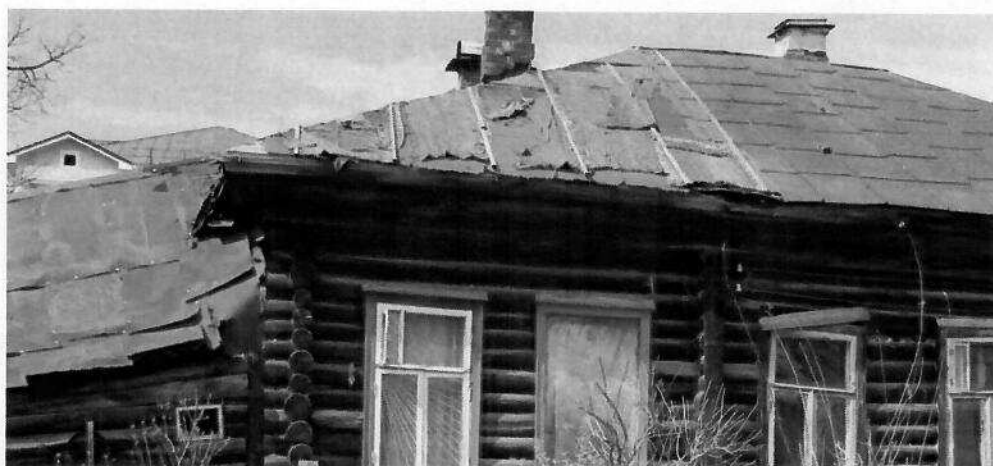
Рис.21. Общий вид на кровельное металлическое покрытие (поверх имеется ремонтный слой, разрушенный). Фото 2019 г.
