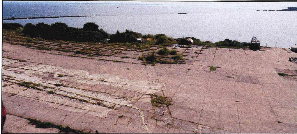
Бетонная площадка стоянки гидросамолетов, справа слип спуска самолетов на воду, на горизонте сохранившееся ограждение бухты.
