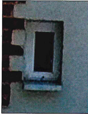
Фото 5. Маломерные оконные проемы на северном фасаде.
