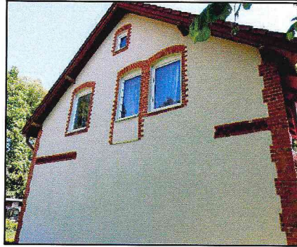
Фото 8. Разорванный фриз «поребрик» на боковых фасадах здания.
