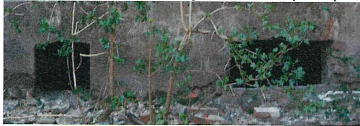
Фото 25. Оконные проемы подвала на северо-восточном дворе фасаде.
