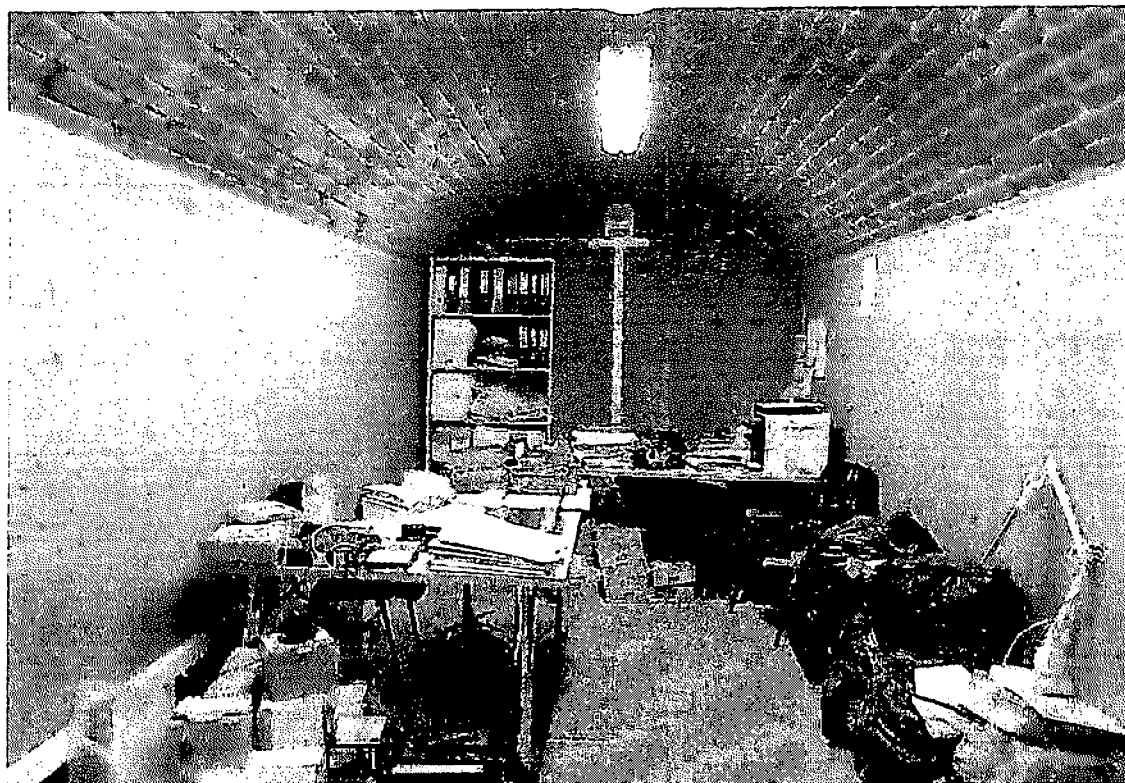
Помещение траверса: отделочные работы не завершены.
