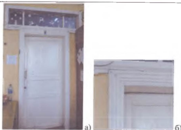
а) Дверь 2-го этажа объема 1937 года; б) Фрагмент обрамления дверного проема объема 1937 года.
